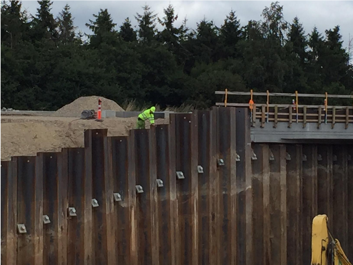
Manglende rækværk og adgangsveje
