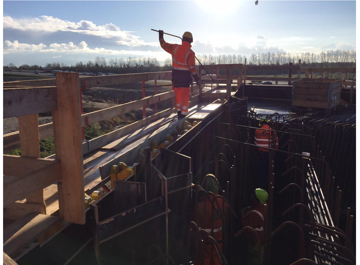
Manglende rækværk , adgangsveje og beredskabsplan
