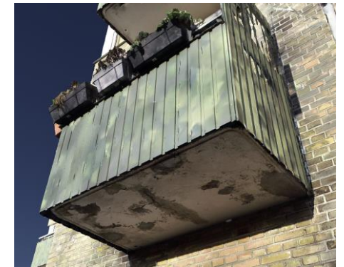
En del skader
