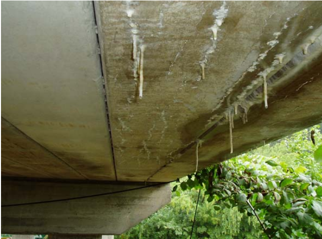
Bro "nr. 1" : Enkelte af elementerne langs den sydlige kantbjælke (ved det østlige vederlag) havde revne-dannelser med tydelige tegn på gennemsivninger.
