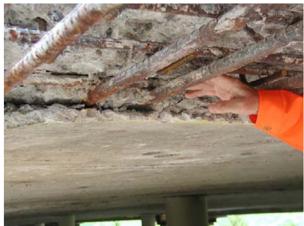
Bro ”nr. 3” : Bro opført i 1970. Slapt armeret pladebro med en mastiks fugtisolering. Foto viser omfattende delaminering af betonpladen.
